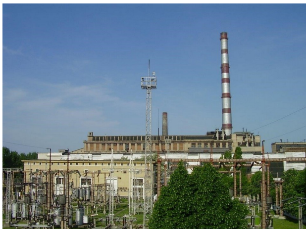
ОРУ и турбинный цех (30 МВт ВН)
